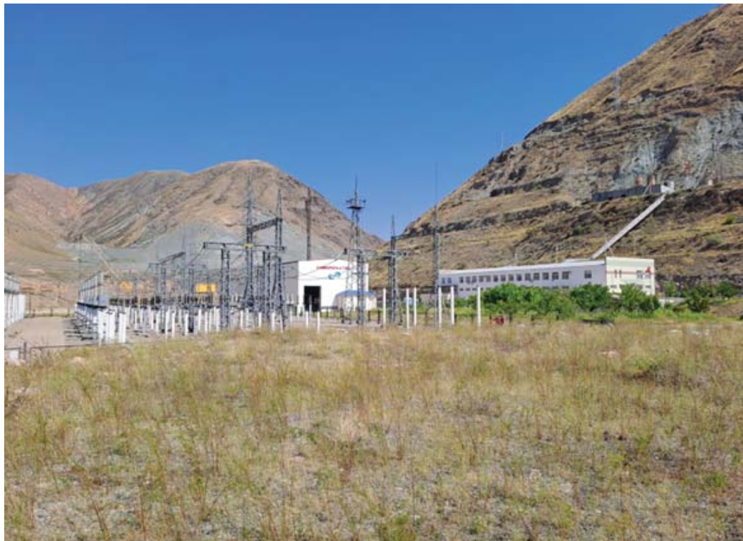
캄바라타 HPP-2-Lot 2, 500KV / 110KV 변전설비 및 송전선로 설비 EPC 공사 Kambarata HPP-2-Lot 2, EPC Construction for 500KV / 110KV Substation and Transmission Line
