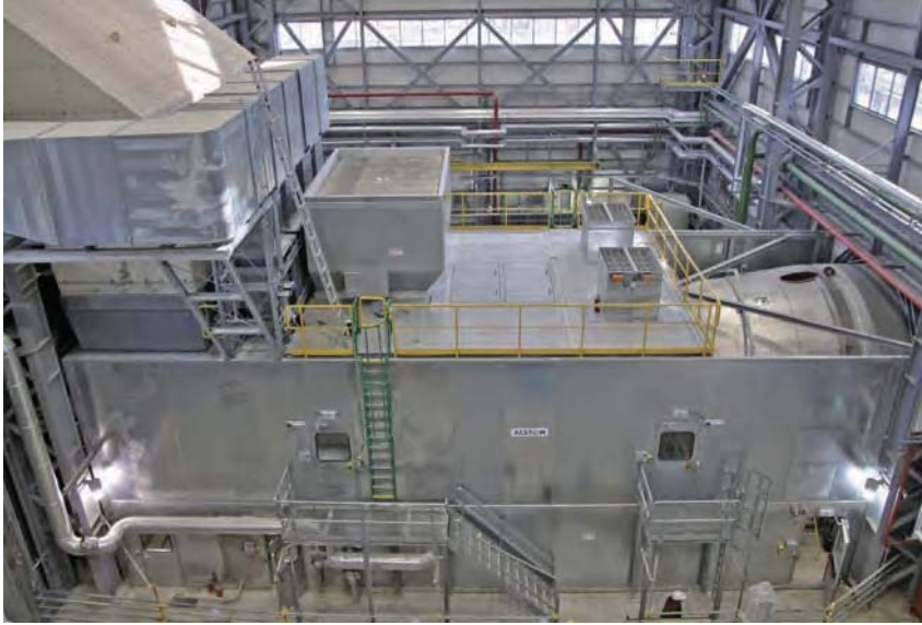
가스 터빈실 Gas Turbine Room, Armenia Yerevan CCPP
