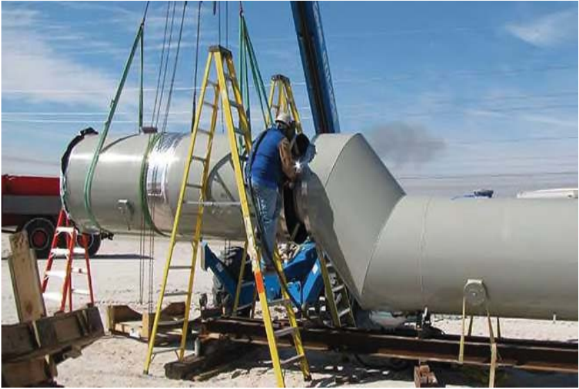
가나 타코라디 T2 발전소 Takoradi T2 Power Project, Ghana
