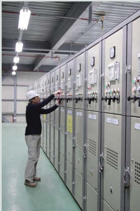
배전반 공사 Distribution Board, Armenia Yerevan CCPP
