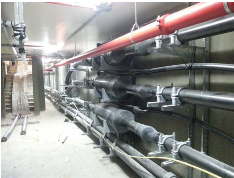
사우디아라비아 초고압 380KV, 800MM 2 XLPE Cable 직선접속 380KV, 800MM 2 XLPE Cable Straight Joint, Saudi Arabia
