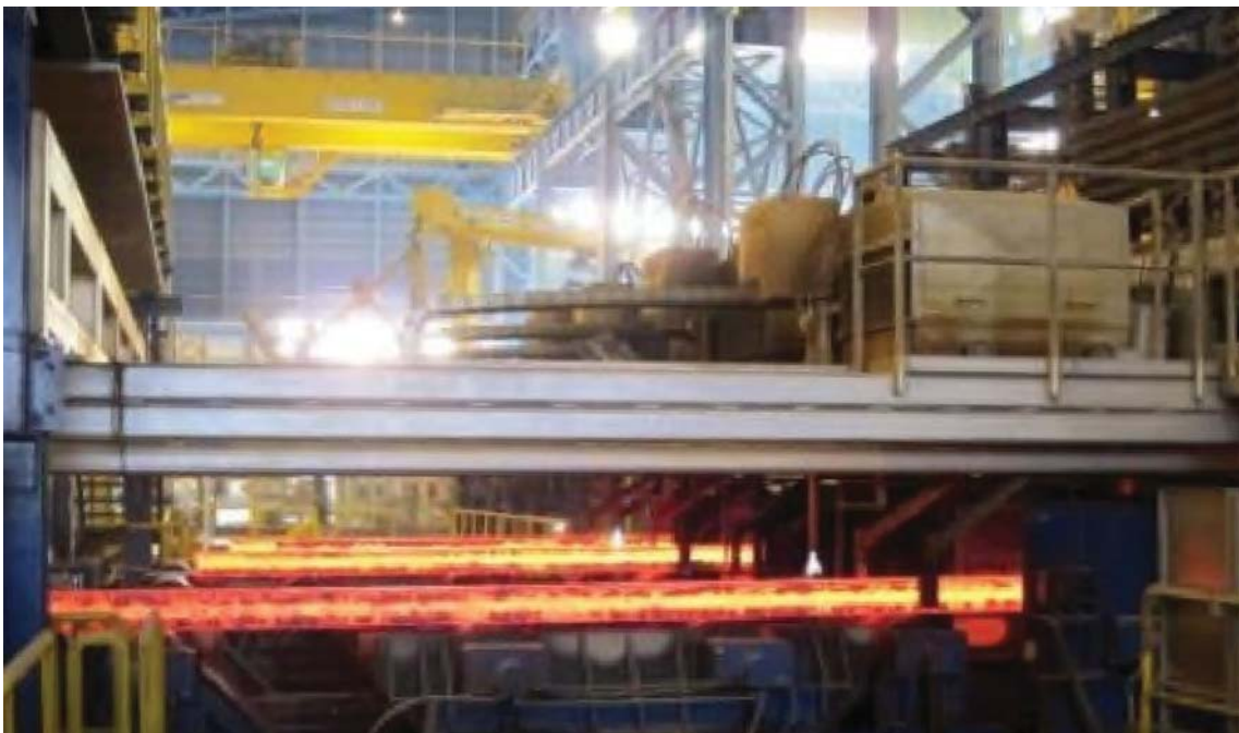
바레인 SULB 철강공장 제작설비 Process Line of SULB Steel Mill Project, Bahrain
