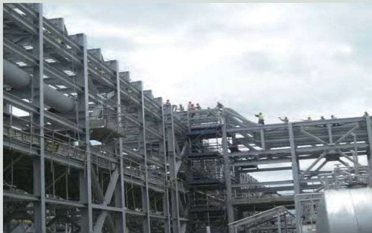
케이블 트레이 Cable Tray Work
