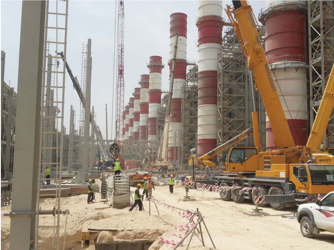
사우디아라비아 꾸라야 발전소 Qurayyah Independent Power Plant, Saudi Arabia
