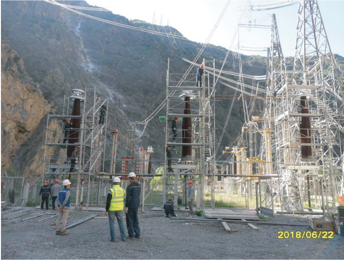
특토굴 수력발전소 Lot 3 케이블 개선공사 - 500KV 케이블 옥외 단말처리 Totogul HPP Lot 3 Cable Rehabilitation - 500KV Outdoor Sealing End
